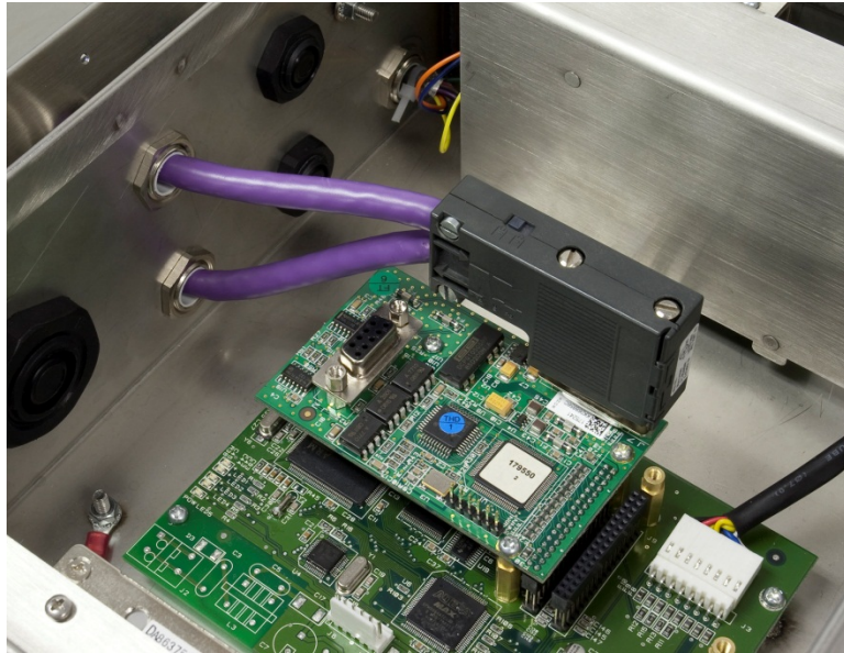
Figure 3-22 : Connexion PROFIBUS dans l'ACM500
