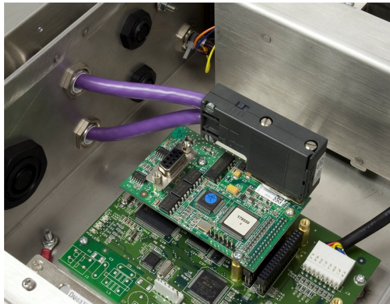
Figura 3-22: Conexión de PROFIBUS en el ACM500
